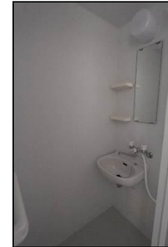
■洗面・シャワー室(単身室)
