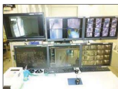
守衛室監視カメラモニター
