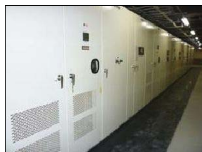
R階電気室
