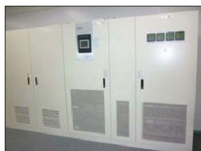
無停電電源装置
