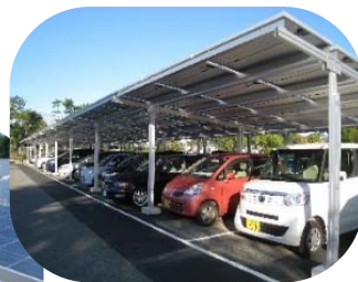
太陽光発電設備 (62kW)
