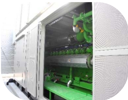
ガスコージェネレーション設備 (2,000kW)
