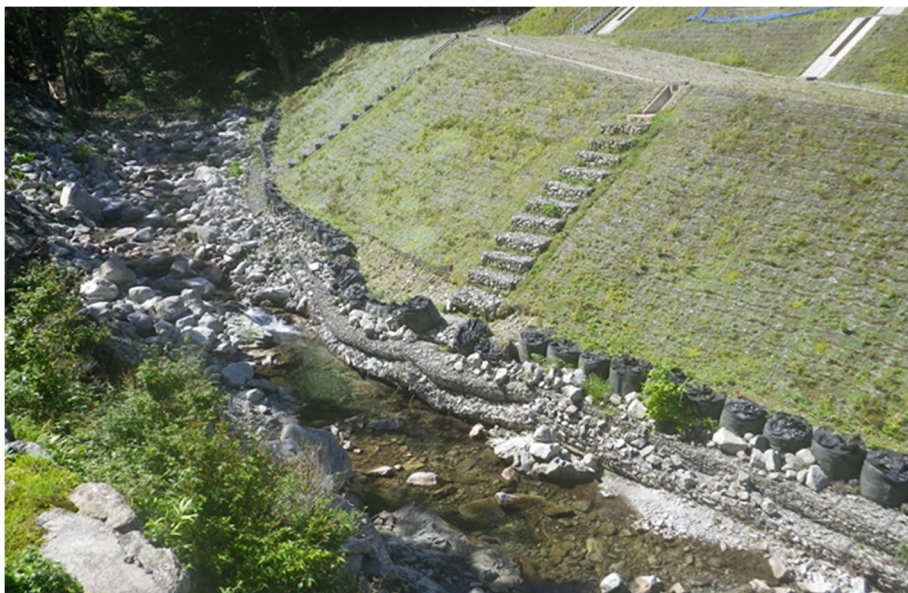
護岸崩落状況写真
