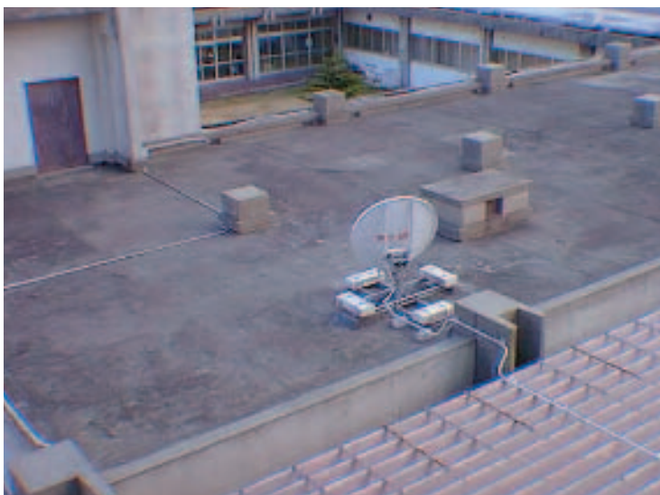
三重大学医学部附属病院の屋上に設置されたパラボラアンテナ The VSAT antenna on the University Hospital
