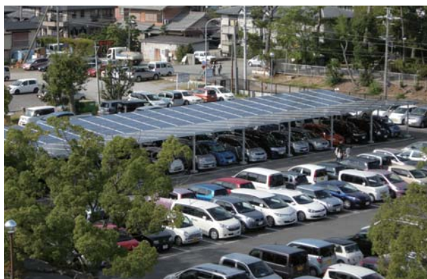
カーポート型太陽光発電設備
