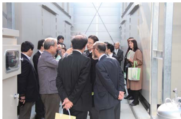
ガスコージェネレーション設備の見学会
