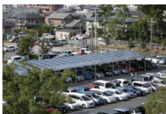
カーポート型太陽光発電設備
