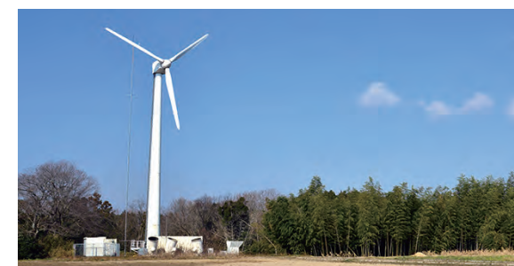
▲ 100kW風力発電装置
