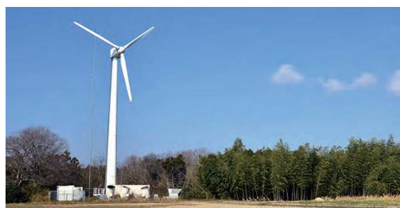
▲ 100kW風力発電装置
