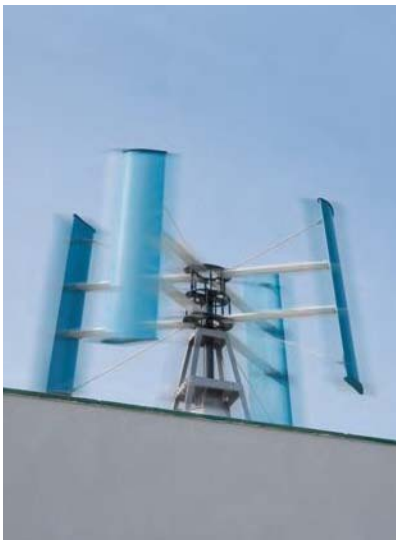
▲小型風力発電機
