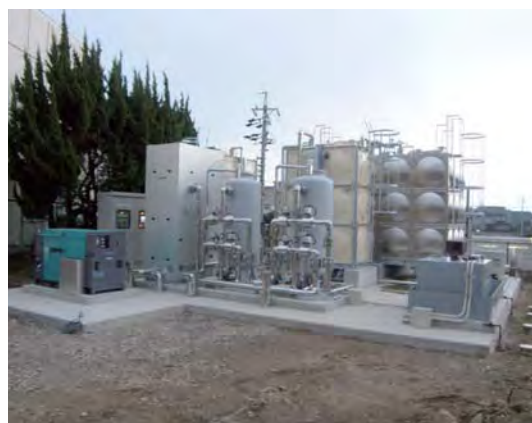
附属学校の地下水供給プラント
