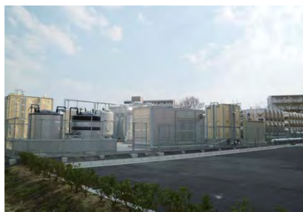
エネルギーセンター地下水供給プラント
