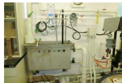
排水処理施設水質分析装置
