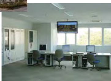
エネルギーセンター2階中央監視室
