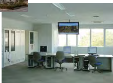
エネルギーセンター2階中央監視室
