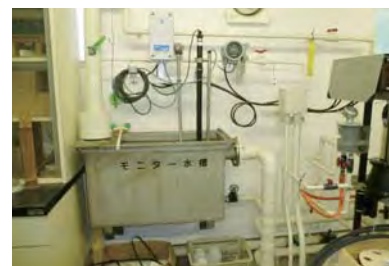
排水処理施設水質分析装置
