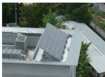
太陽光発電設備 10kW (エネルギーセンター棟の屋根)
