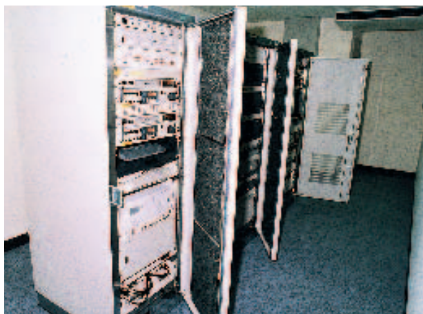
図4. SCSのメインの装置 Fig. 4. Main Equipment of SCS
